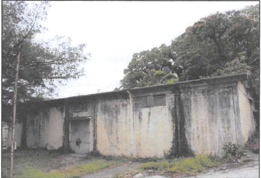
Foto Penyimpanan Suku Cadang Listrik ( Storage Electrical Spare Part ) Tampak Depan
