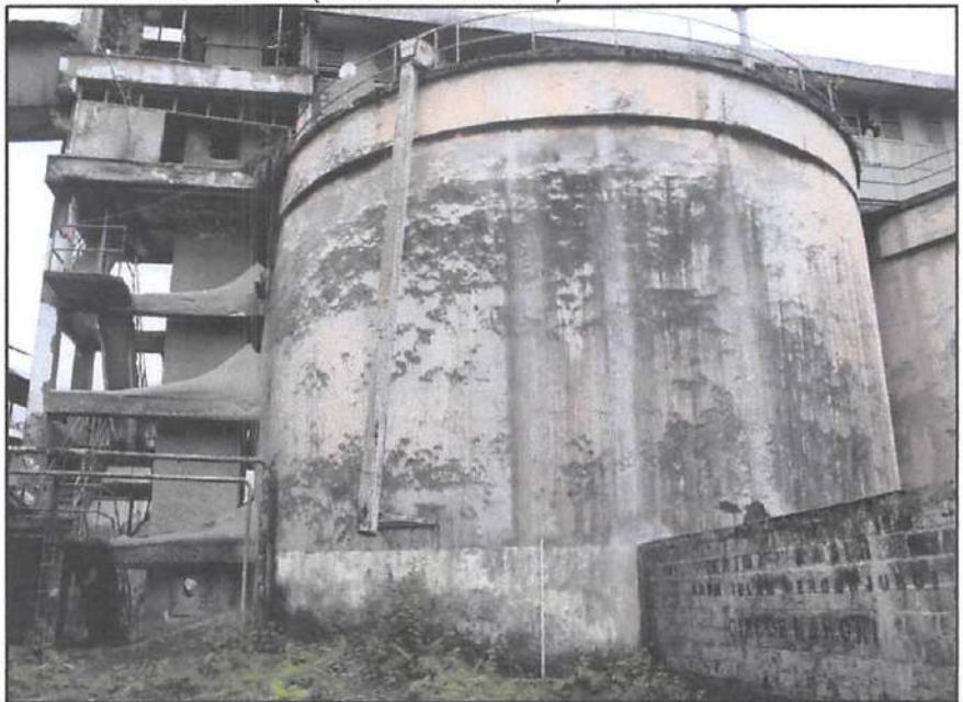
Foto Silo Semen B ( Cement Silo B ) Tampak Depan
