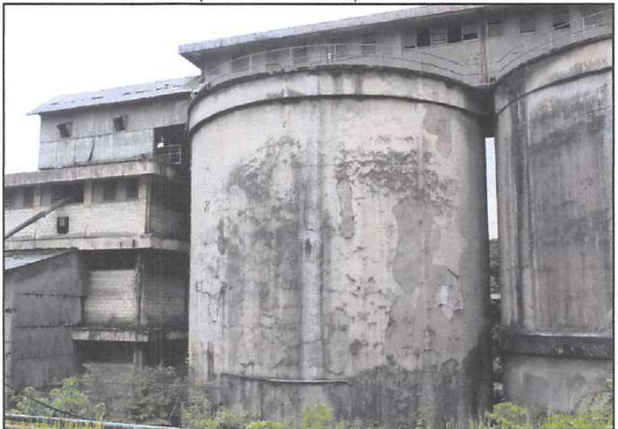
Foto Silo Semen A ( Cement Silo A ) Tampak Depan
