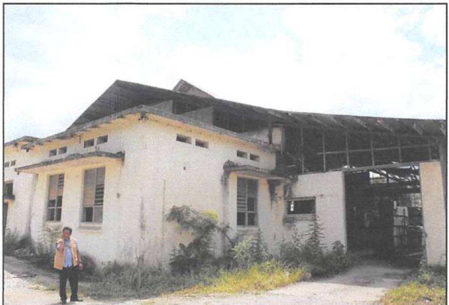
Foto Bengkel ( Workshop ) Tampak Depan
