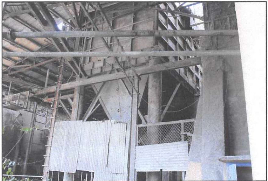
Foto Silo Semen ( Cement Silo ) Tampak Dekat (Sumber: Dok. Tim Pendaftar, 2022)
