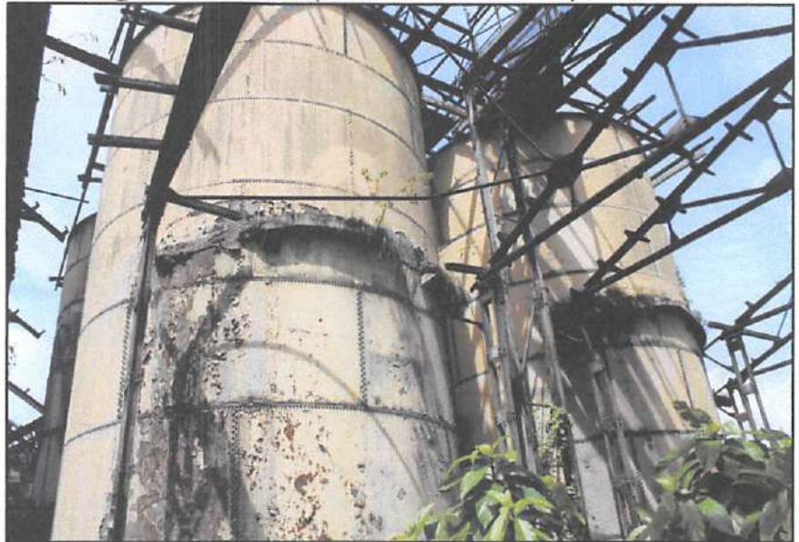
Foto Tangki Koreksi A ( Correction Tank A ) Tampak Depan
