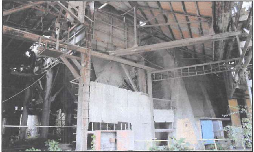
Foto Silo Semen ( Cement Silo ) Tampak Depan
